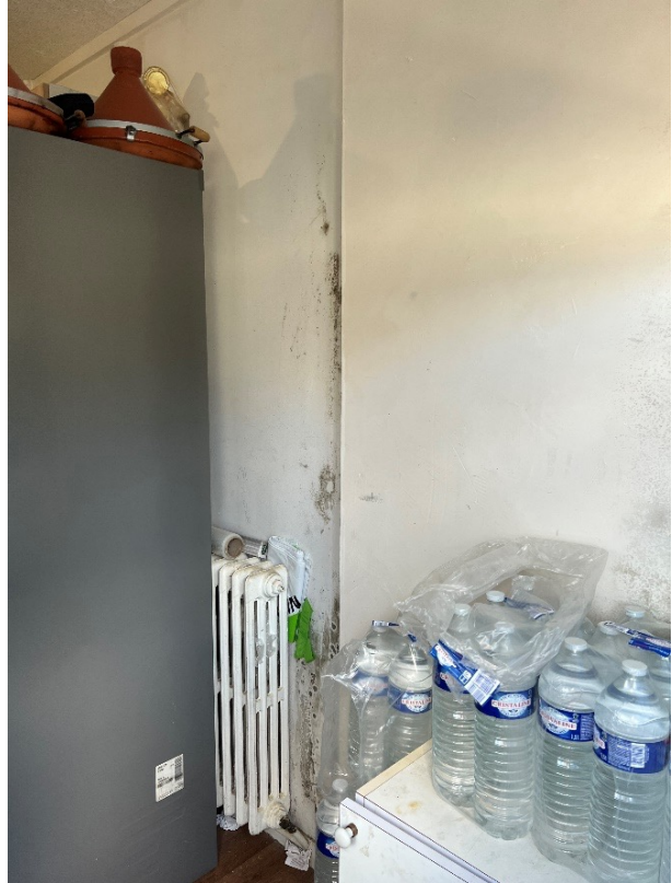
Humidité dans un appartement locatif social suroccupé de l'Avenue de Verdun, Trois Ponts, Roubaix © ADULM, 2024.
